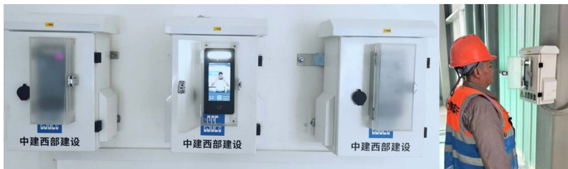
图：维修人员使用人脸识别设备
